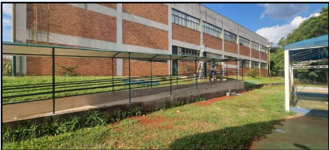
Obras de Adequação, Reforma e Ampliação de Salas de Aula em Universidade
