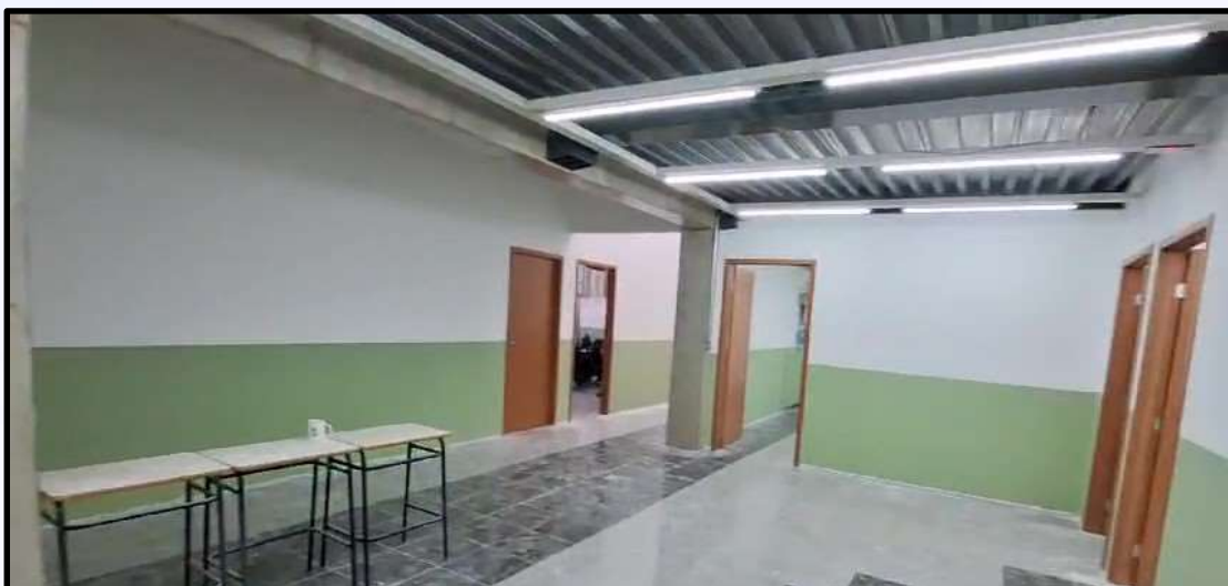
Obras de Adequação, Reforma e Ampliação de Salas de Aula em Universidade
